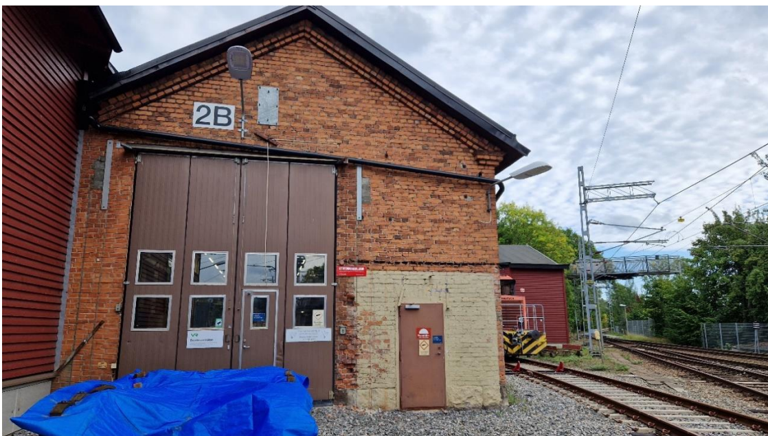
Figur 19. Tegelbyggnaden är i stort behov av underhåll och restaurering, men den dekorativa tegelfrisen under takfoten visar att man har lagt ner omsorg på utformningen när huset uppfördes och att byggnaden tillmättes ett stort värde.
